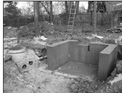
Betonové lože, v němž se pohybuje kyvná deska, vytvářející příbojové vlny v jezírku - foto R.Kössl
